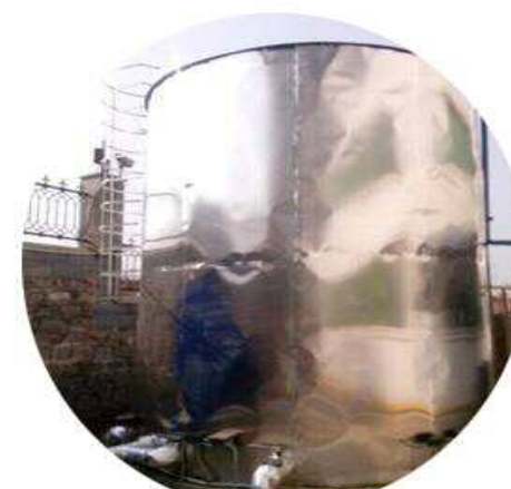
安吉通汇废水运营项目
