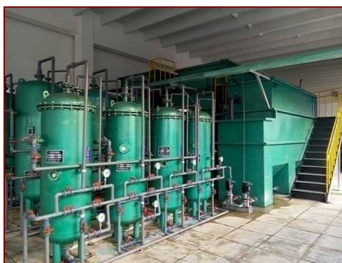
首钢东星电镀废水处理项目
