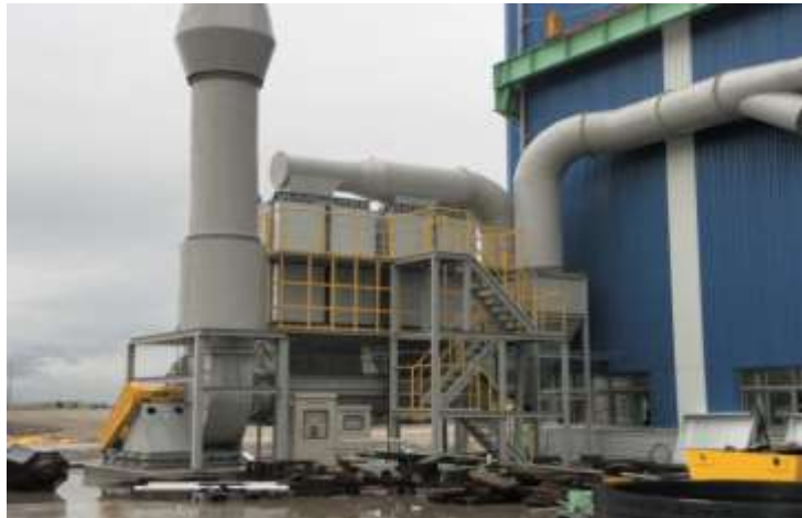
◎ SPP 1,500CMM 集塵設備
