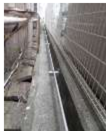
水素供給配管
