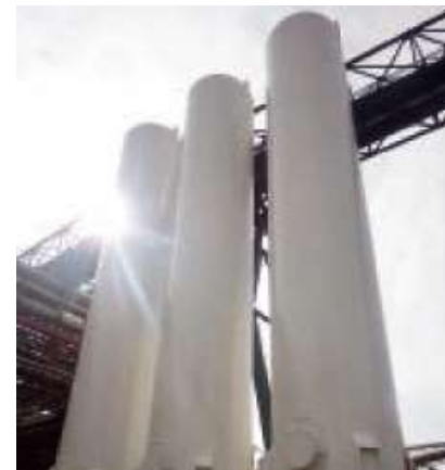
未利用水素を回収するバッファドラム (株式会社トクヤマ徳山製造所内)
